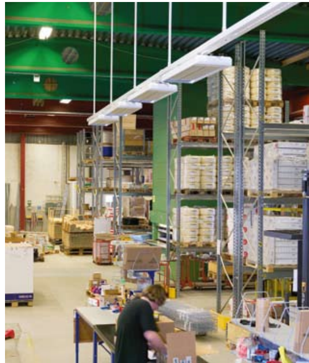
EZ200 eignet sich ideal, um Arbeitsstationen zu heizen.
